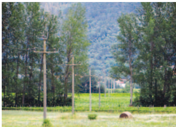
Slika 6. Koridor daljnovoda skozi protivetrni pas.
